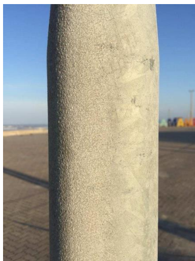
Figura 04 – Abrasão devido as rajadas de vento com areia
