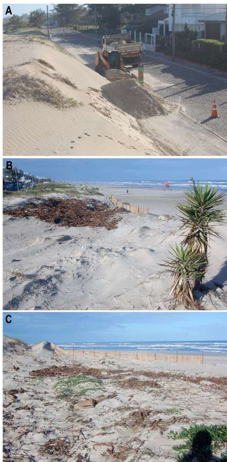
Figura 3.5- De cima para baixo: A) retirada de areias eólicas por máquinas em cima do passeio de Atlântida, que por gravidade precipitam pela face livre da duna; B) tentativa de estabilização das dunas por métodos estruturais (sandfence e cobertura morta) em uma ruptura conectada a bacia de deflação eólica alongada, e C) brecha oriunda de migração de cristas de dunas frontais para o interior, mais ao sul.
